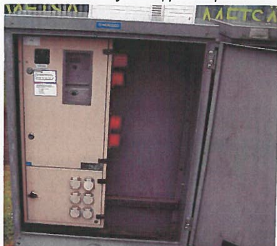
Kuva: Torin jakokaapin Puumalan kunnan keskuksen puoli
